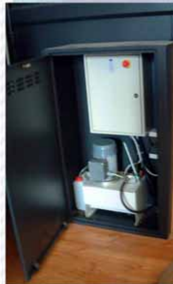
Quadro/centralina in armadio
